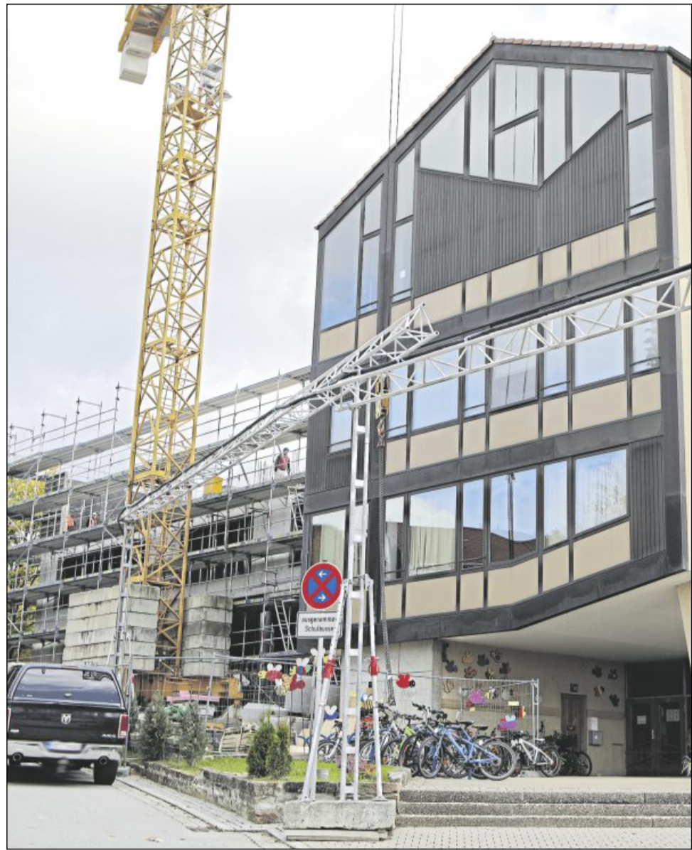
Während der Sanierungsplanung der Urbanschule wurde Asbest in einer Fassadenverkleidung und im Küchenboden gefunden. Foto: Palmizi
